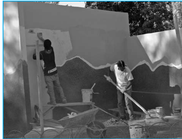
新しく設置された公共トイレの最終仕上げに取り組むチリ、コンバルバラの労働者たち。
